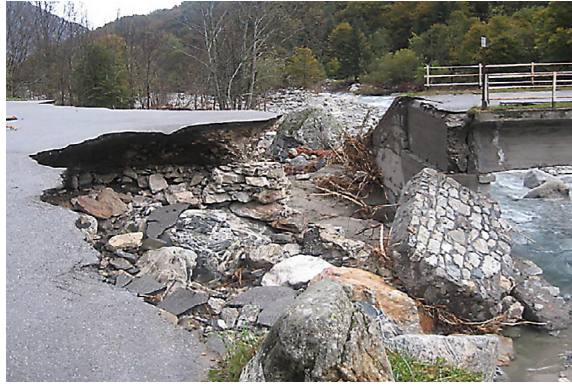
Image 3 : voie d'accès au refuge Pagari après la tempête Alex
