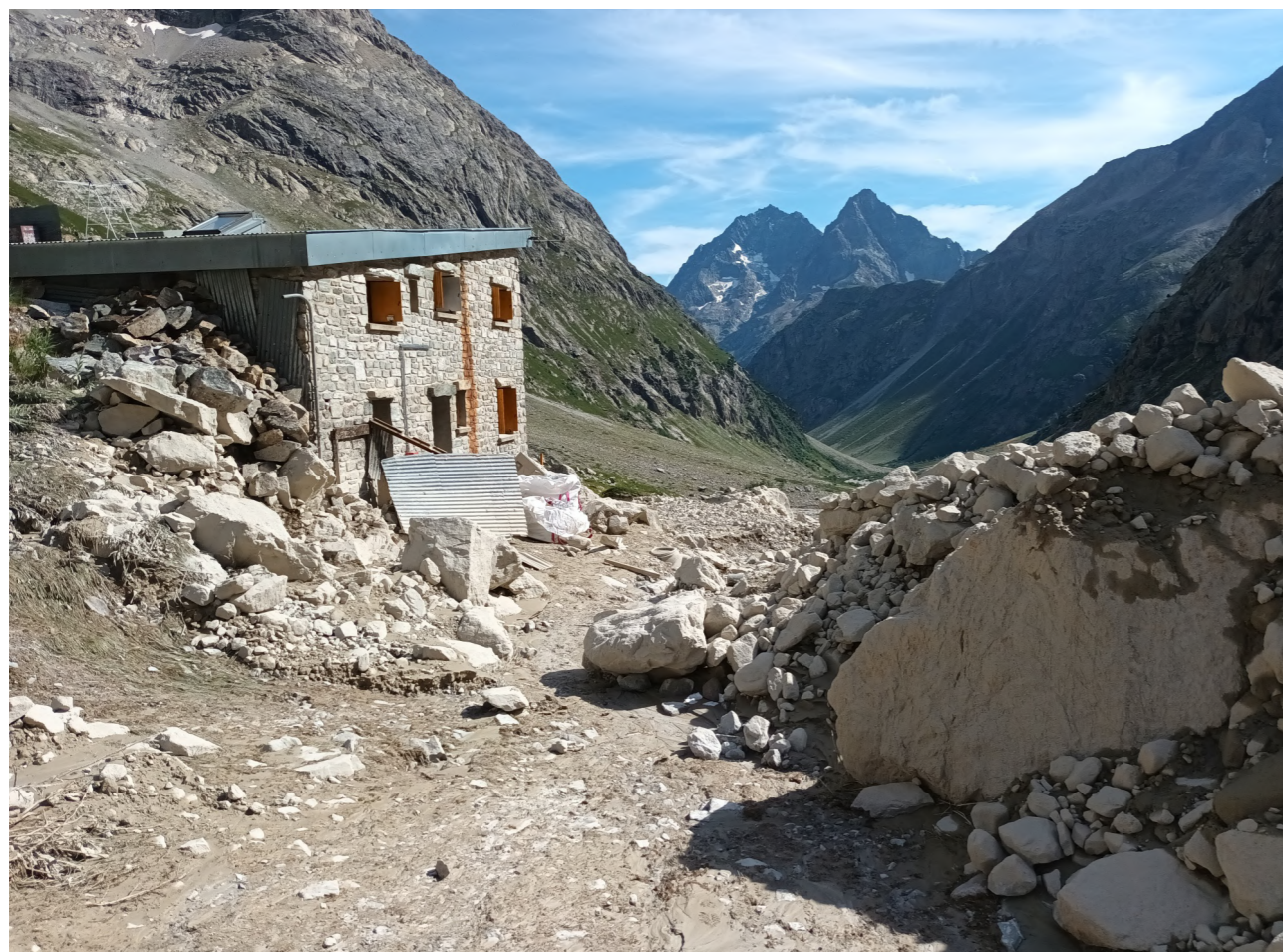
Les traces des dégâts causés par les orages du 29 juillet 2022 au refuge du Châtelleret ©P-H. Peyret - Parc national des Écrins
