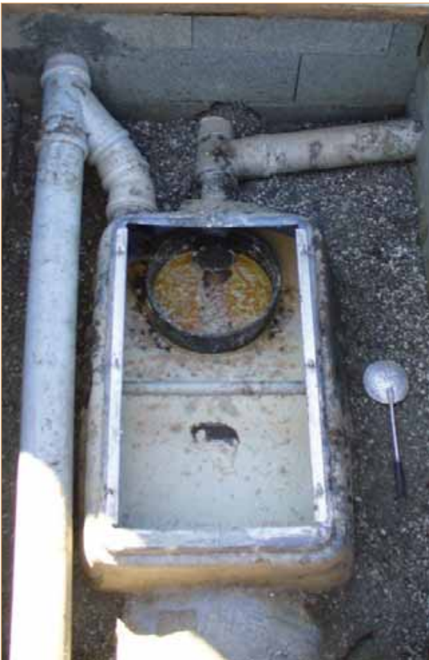
Figure 8 : Séparateur de graisses du refuge de l'Arpont - Vanoise en fosse bétonnée (photo PNV).
