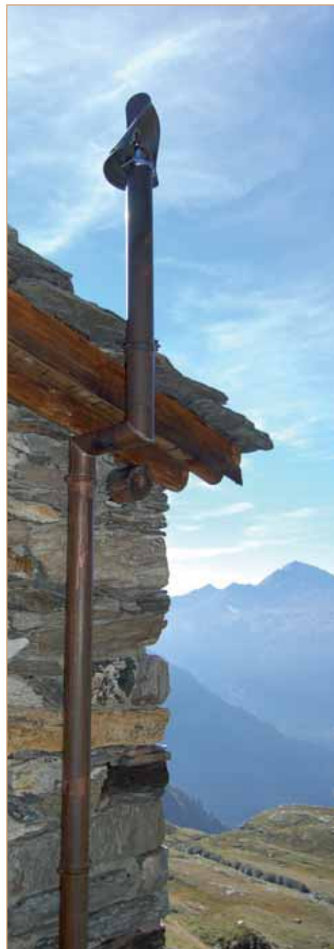
Figure 17 : Ventilation haute en toiture refuge de l'Arpont – Vanoise (photo PNV).
