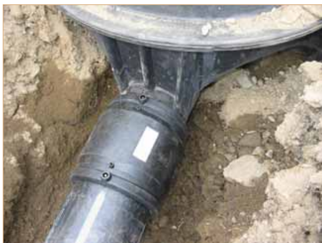
Figure 34 : Raccord électrosoudé sur tube PEHD – refuge de l'Arpont (Photo PNV).
