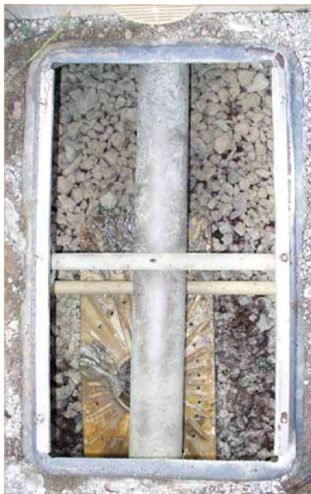
Figure 26: Photo de filtre bactérien percolateur sur pouzzolane – Refuge de l'Arpont – Vanoise (photo PNV).
