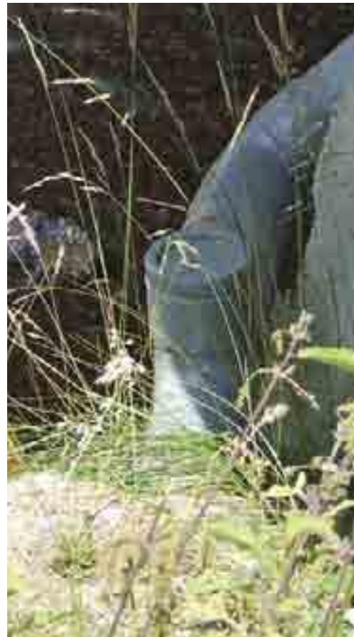
Évacuation fosse (refuge de l'Oule)
