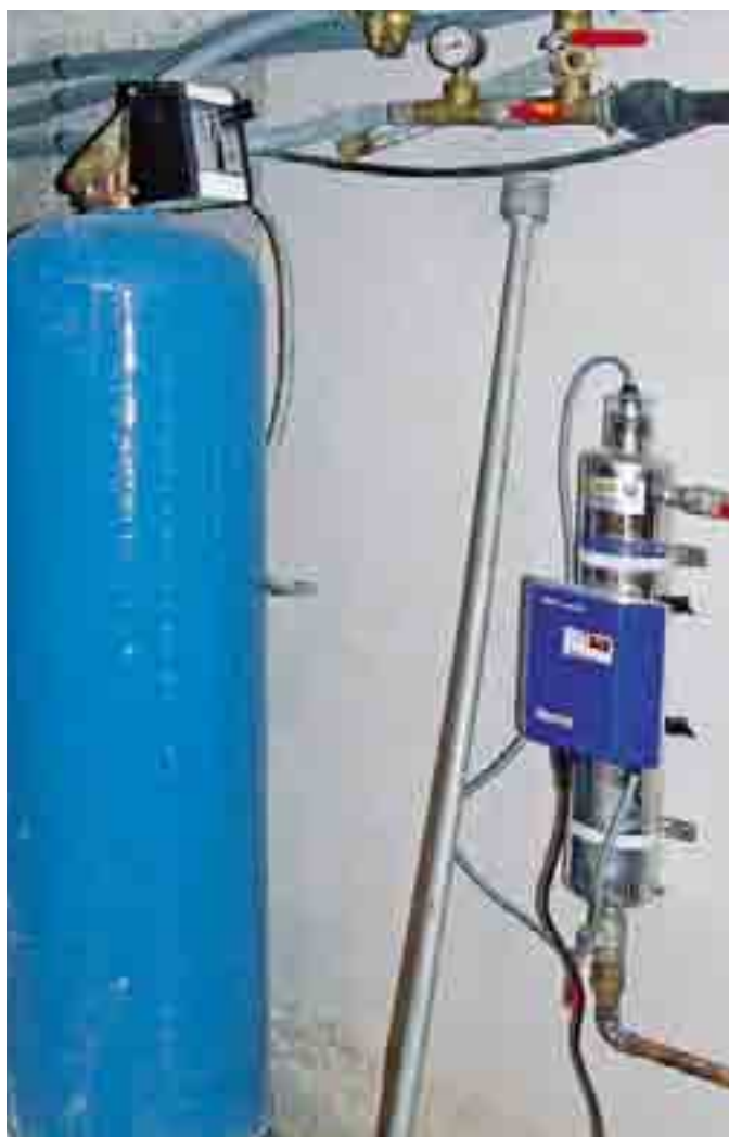
Filtre à sable et U.V. (refuge des Oulettes)
