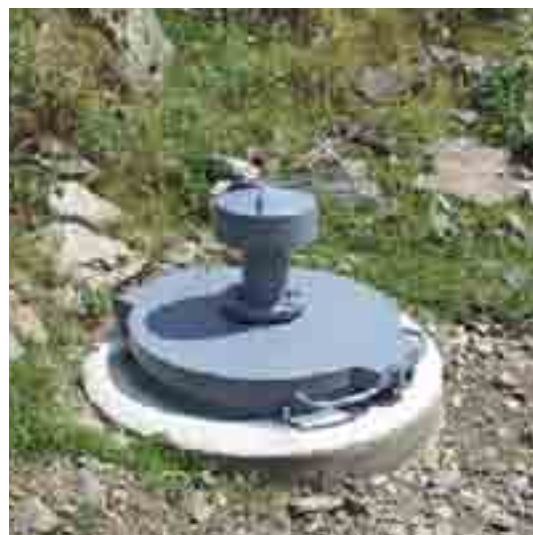
Captage (refuge de l'Oule)
