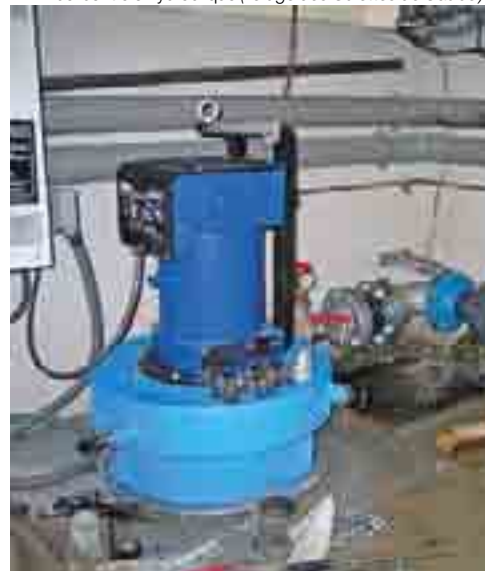
Pico-centrale hydraulique (refuge des Oulettes de Gaube)
